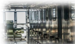
計器室 (コントロールルーム)
